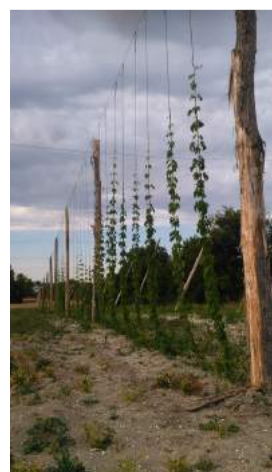
Le montage de la houblonnière a été particulièrement ardu. Elsa et ses proches ont eu besoin d'utiliser une nacelle pour y parvenir.
