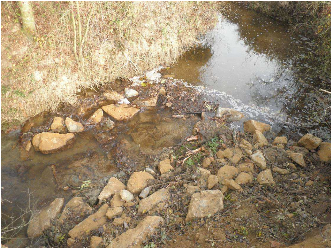
Radier placé en aval de la zone d'érosion régressive et en sortie de méandre sur la zone de dépôt naturel
