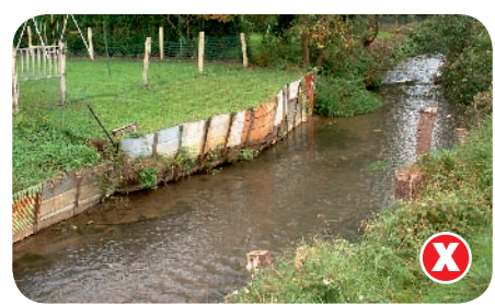
L'AUDRY : tentative de protection inadaptée. (source UDASA)
