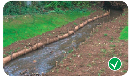
SIGNY-LE-PETIT : exemple de protection de la berge en technique végétale sur le Bosneau. (source DDEA)
