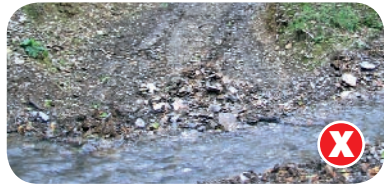
Destruction du lit par le passage d'engins. (source AERM)
